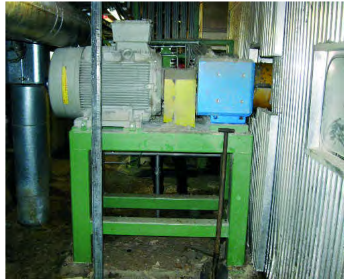
Abb. 1: Standardmotor und Vorgetriebe auf Konsole, außerhalb der Trockenhaube
