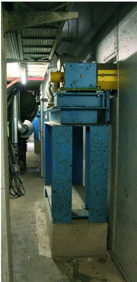
Abb. 12: Der Bauraum hinter der Papiermaschine 1 ist eng. Künftig können die außerhalb der Haube liegenden Fundamente und Motoren bzw. Vorgetriebe-konsolen entfallen.
