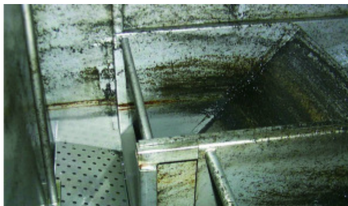
Abb. 3: Ablagerungen im Entgasungsmodul
