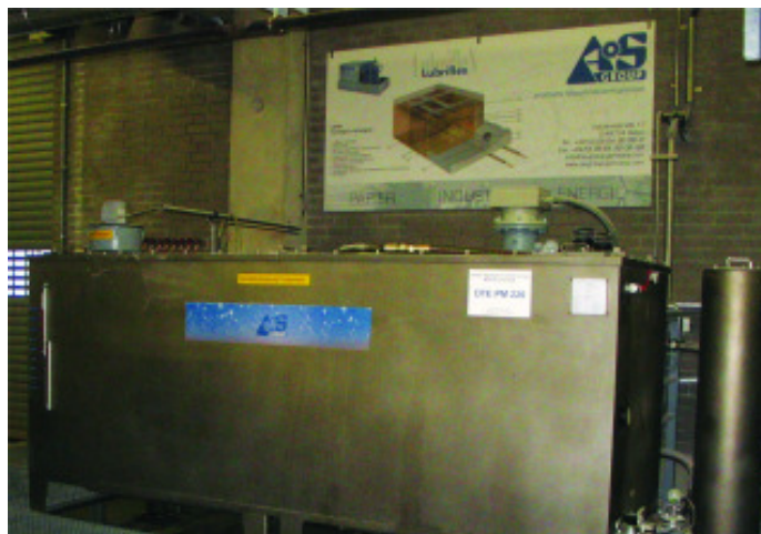
Abb. 1: Öl-Umlaufschmieranlage Lubriflex® Typ MAXI, Installation 2004, Aufnahme 2009
